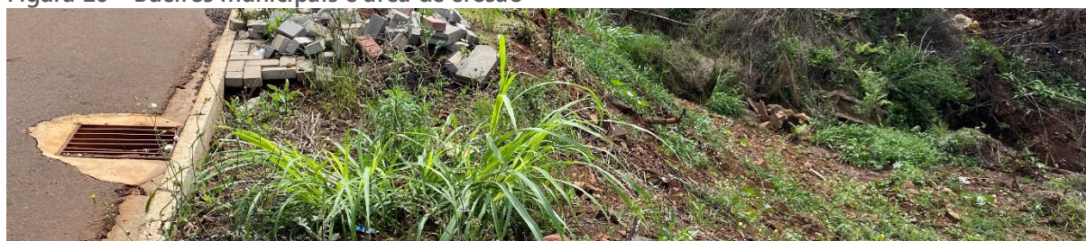
Figura 26 – Bueiros municipais e área de erosão
