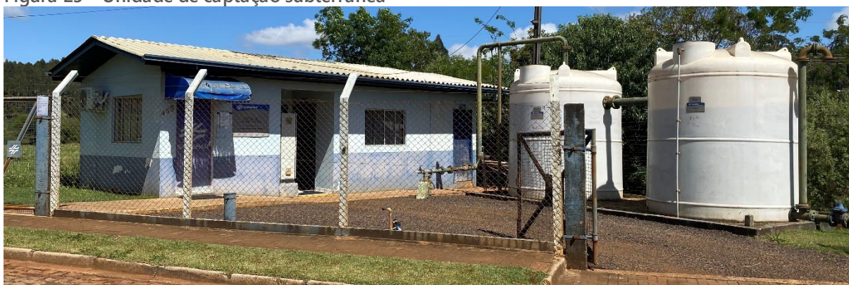
Figura 25 – Unidade de captação subterrânea
